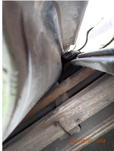
Foto 12: rechts, bij controle blijkt vogelschroef te ontbreken.
