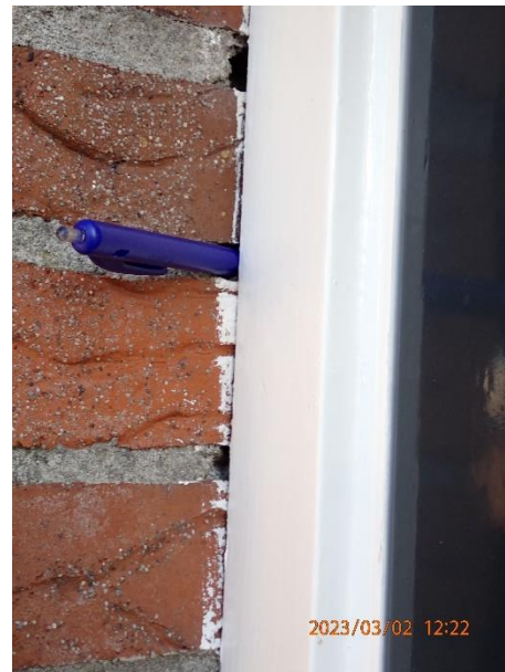
Foto 4: rechts, tussen het metselwerk en kozijnen zitten spleten.
