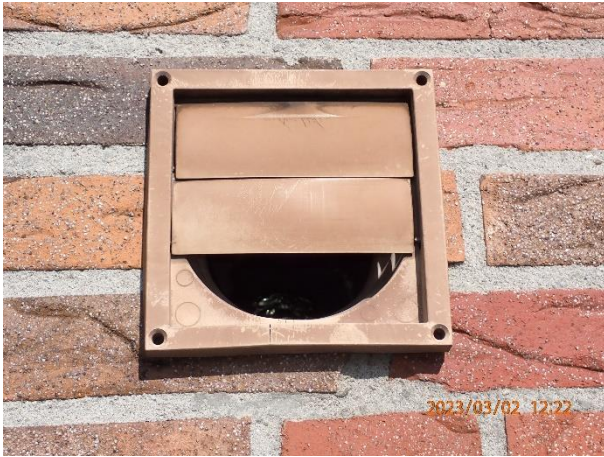
Foto 7: links, dit is een afvoer die niet volledig afgedicht is.
