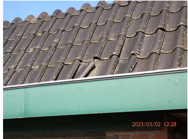
Foto 10: rechts, dit is een andere locatie waar de dakpannen zijn verschoven.
