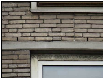
Figuur 12. Open stootvoegen in het metselwerk.
