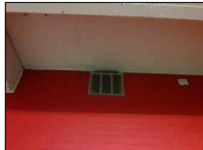
Figuur 14. Ventilatie-rooster met spleet in parkeergarage van het complex.
