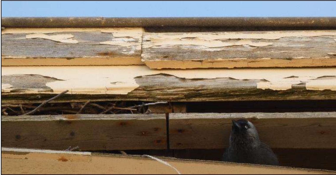
Figuur 9: In de gootbekisting aan de zuidwestzijde van het gebouw zijn nesten van kauwen aanwezig.
