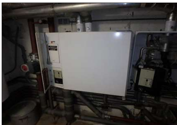
Cv installatie Niet asbestverdacht
