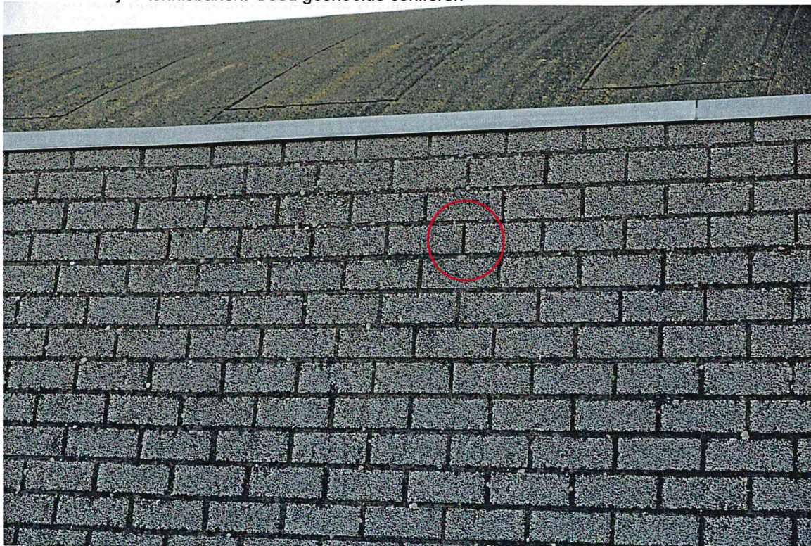
Foto 2 noordzijde tennishallen, het ontbreken van bijenbekjes in de open stootvoegen
