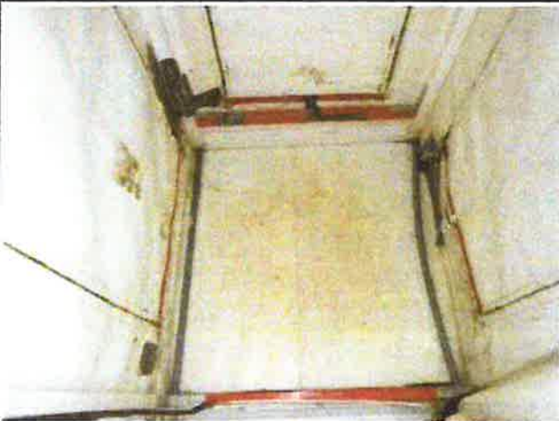
Foto 9. Vuile ruimte van de deco-sluis.
