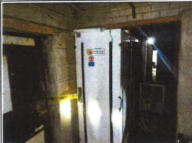
Foto 2. Opstelling 3-delige deco-sluis.
