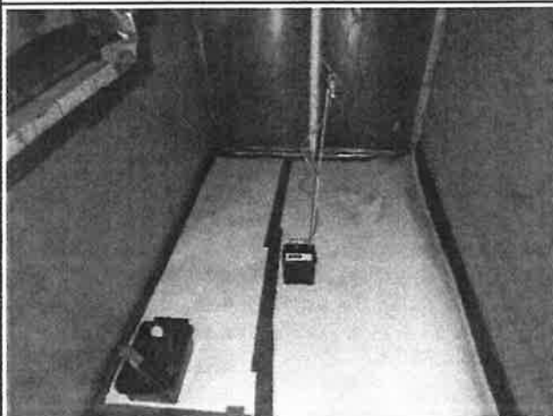
Foto 9. Opstelling meetpunt 1, pompnr. 57.
