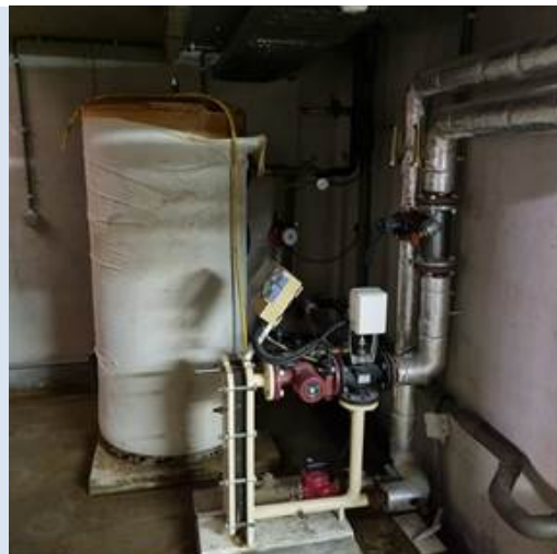
Indirect gestookte boiler kleedkamers doelgroepenbad en fitness
