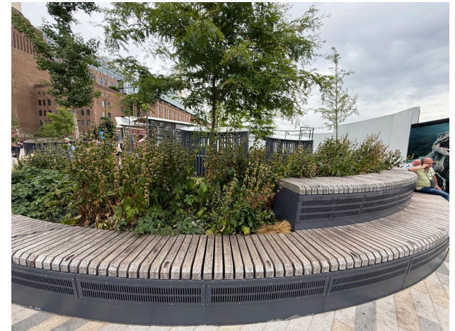
Ventilatoren zijn geïntegreerd in zitbanken. Bron: Battersea Power Station omgeving, London (VK)
