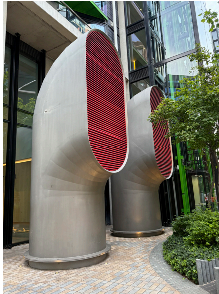
Ventilatoren maken onderdeel uit van het ontwerp. Bron: Battersea Power Station omgeving, London (VK)
