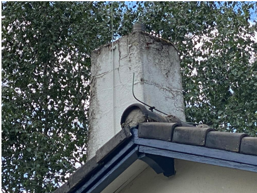
Foto 1: De dakconstructie is ongeschikt voor broedvogels met jaarrond beschermde nesten. Zo is te zien dat de nokpannen met beton zijn afgedicht, waardoor er geen plek is voor gierzwaluwen om deze te gebruiken. Ook de dakconstructie aan de kopse kant is vanwege het gladde houtwerk ongeschikt om als invliegplek te dienen
