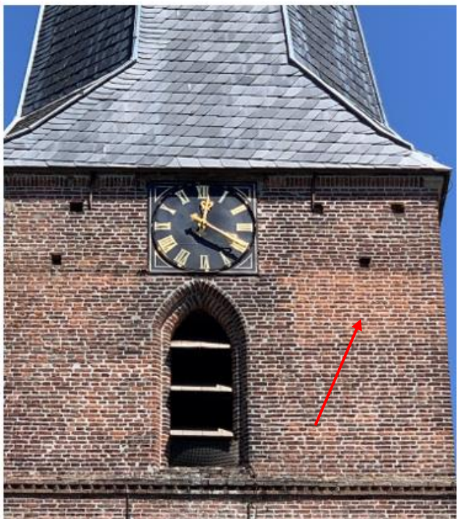
Figuur 14: Zichtbaar herstelde schade granaatinslag (rode pijl)
