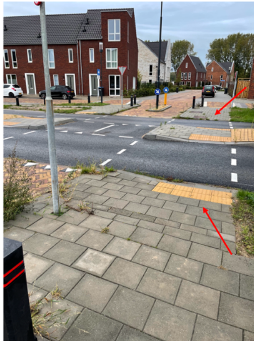
Foto 12: Deze oversteekplaats bevindt zich op de grens tussen twee projecten, elk met een andere projectleider. Door gebrek aan communicatie tussen projectleiders ontbreken geleidelijnen aan één kant van de kruising.
