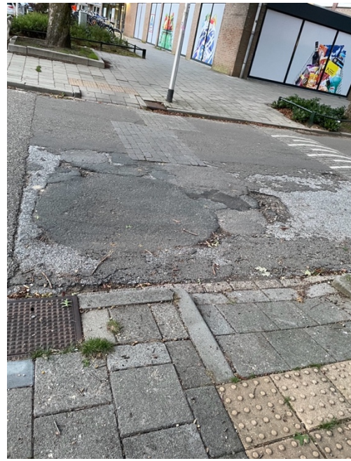
Foto 2 Slecht onderhoud op het kruispunt Kanunnik Pelsstraat en Kanunnik Mijlincstraat
