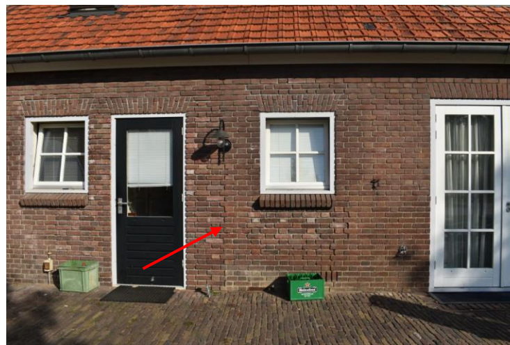
Gedeelte achtergevel tussenlid (links) en woongedeelte (rechts). De rode pijl wijst inboetwerk aan.
