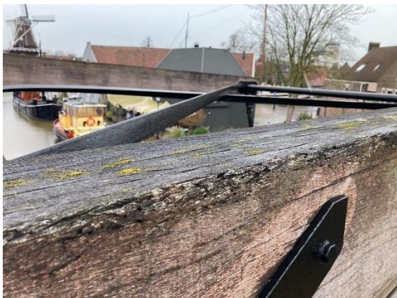
Lengtescheuren in de balanspriem en hameipoort veroorzaakt door uitdroging van het hout.
