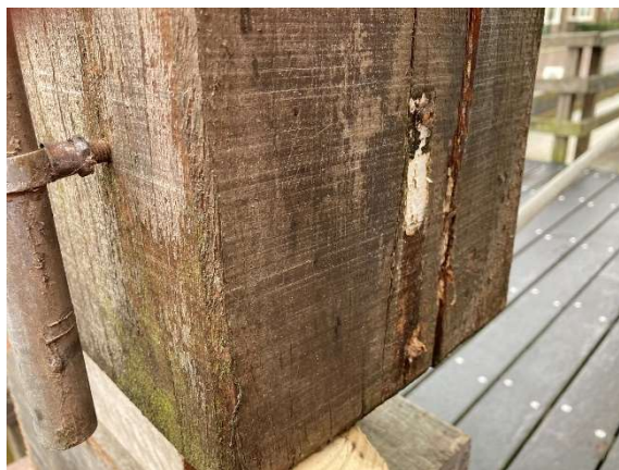
De witrot was slechts op enkele kleine plekken aan de buitenzijde van de hameistijlen en de balanspriemen zichtbaar.
