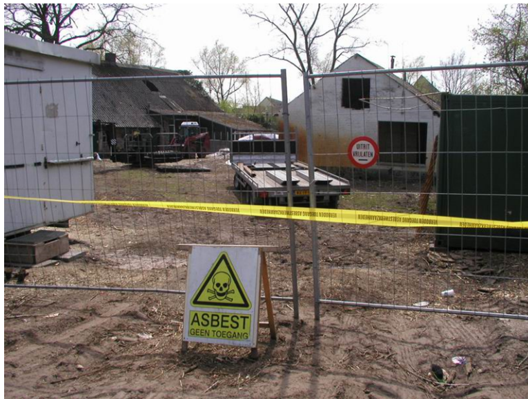
Figuur 17: Afscherming van een asbestverdachte locatie
