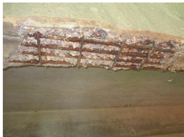
Foto 6 Roestende wapening onderzijde balk
