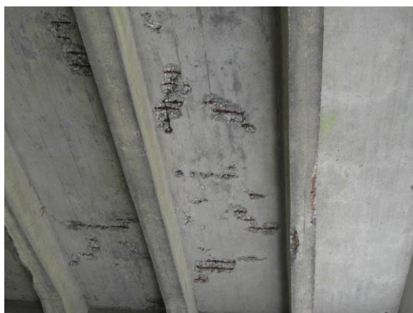
Foto 9 Schadeplekken onderzijde dek
