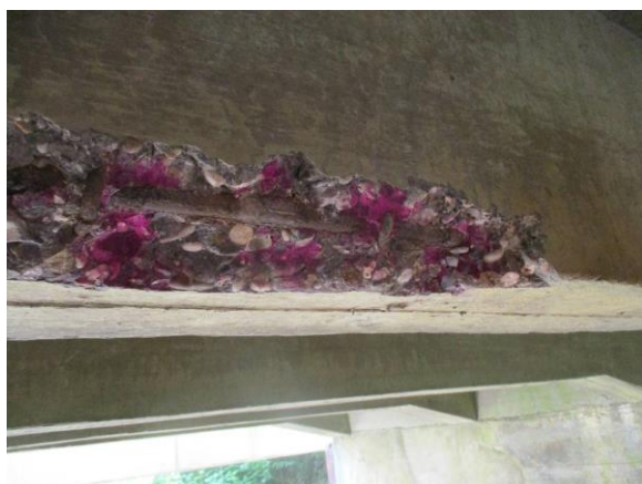
Foto 11 Carbonatatiemeting t.p.v. schadeplek balk
