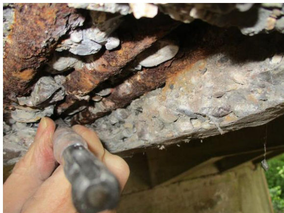
Foto 13. Holle ruimte achter oppervlak balk
