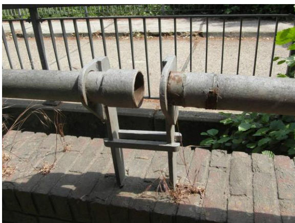
Foto 41 Schade aan leuning
