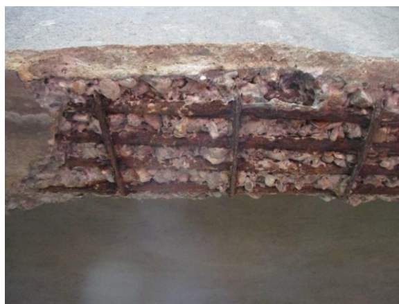
Foto 10 Roestende wapening onderzijde balk
