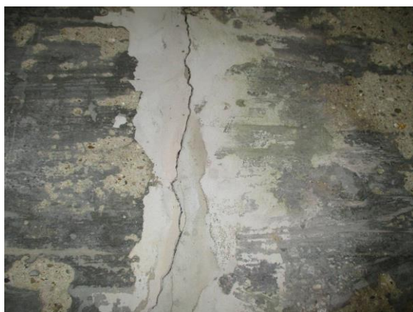
Foto 23. Scheurvorming landhoofd noord
