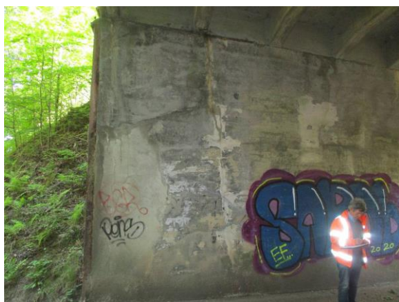
Foto 21. Schadeplekken en scheur landhoofd noord
