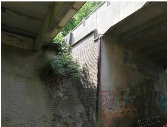
Foto 27 Betonschade frontwand oost
