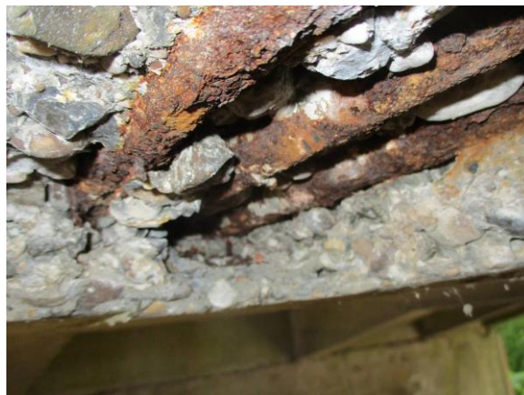
Foto 14. Holle ruimte achter oppervlak balk
