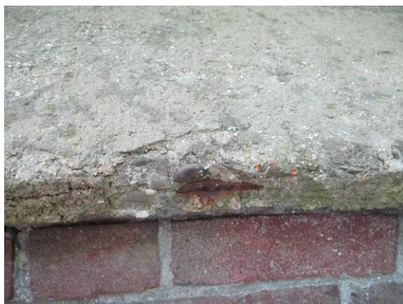
Foto 33 Betonschade borstwering / frontwand oost
