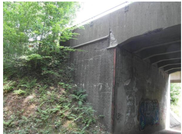
Foto 28 Betonschade frontwand west
