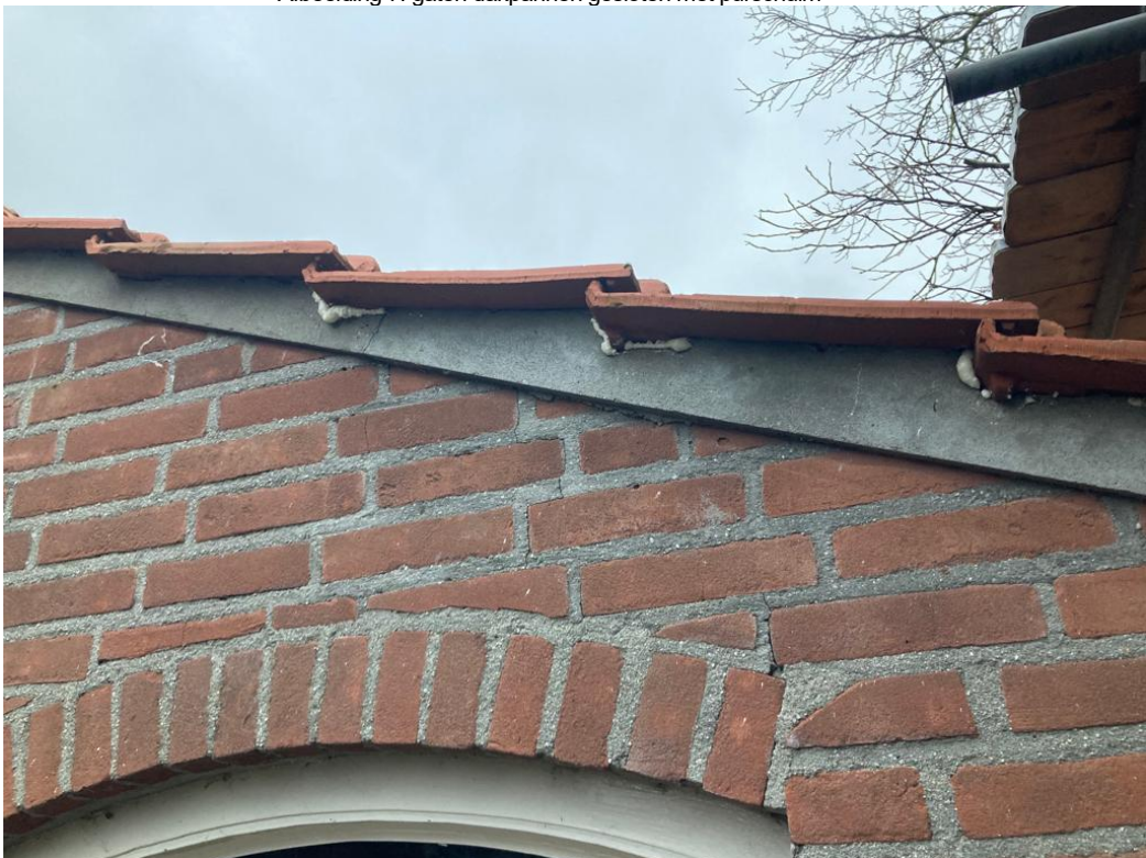
• Afbeelding 7: gaten dakpannen gesloten met porschuim
