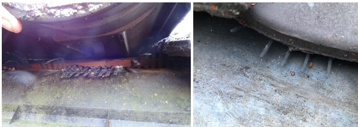
Afbeelding 14 en 15: vogelschroot onder dakpannen woning en bijgebouwen. Bron: BNL advies, datum: 07-02-2022
