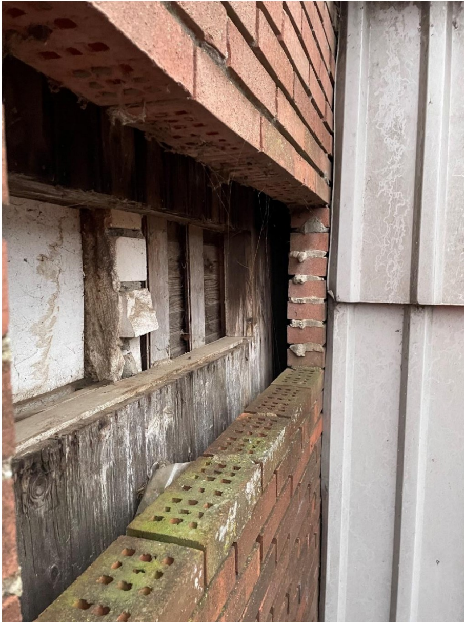
Foto 10: bij de noordelijke gevel van de zuidelijke schuur is een gevel voorgebouwd. De raamstukken zijn niet goed afgewerkt.
