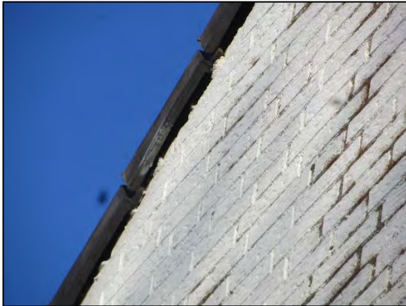
Foto A: Openingen onder dakpannen Markt 89
