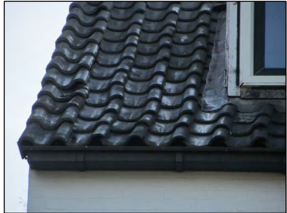
Foto B: Openingen onder dakpannen Markt 89
