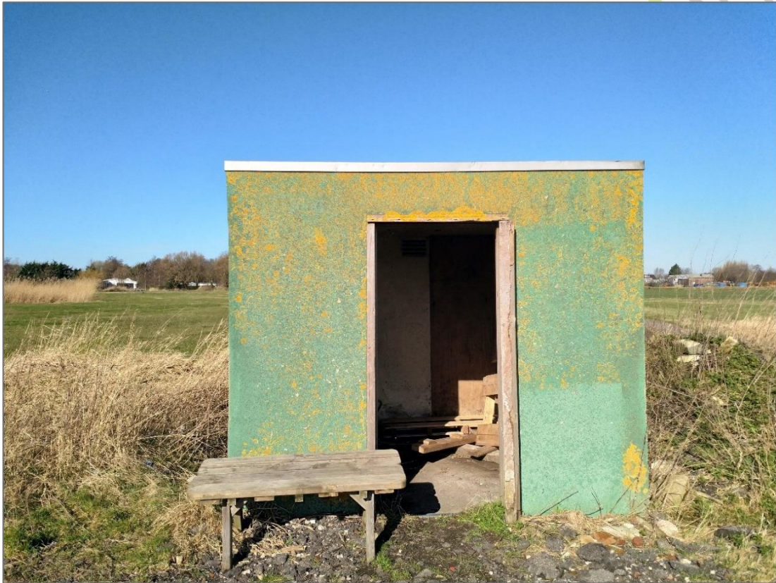
Figuur 3: De enige bebouwing binnen het plangebied. Foto: M.S. de Haan | Ecoresult B.V.
