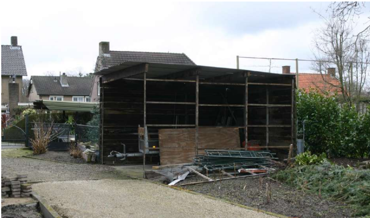
Figuur 4.2.1. De schuur is halfopen en geheel enkelwandig. Vleermuisverblijven, vogelnesten, etc. zijn hier afwezig.
