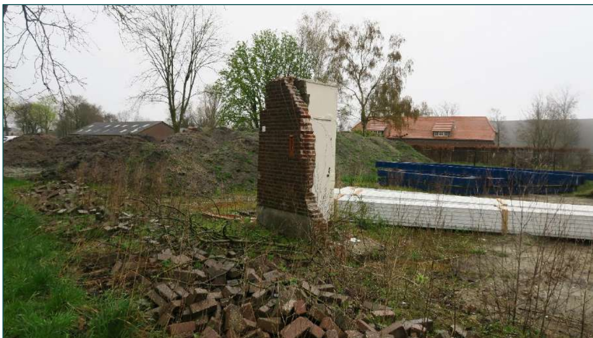
Figuur 2 Restant van de reeds gesloopte woning.
