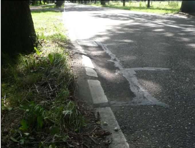
Voorbeeld schade wortelopdruk
