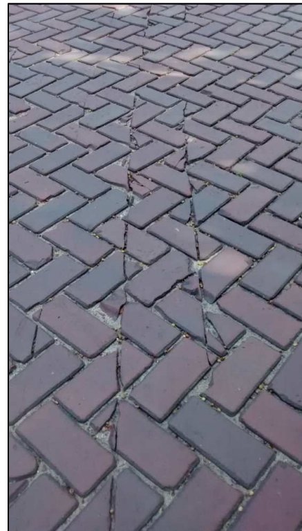
Voorbeeld Schade aan gebakken klinker
