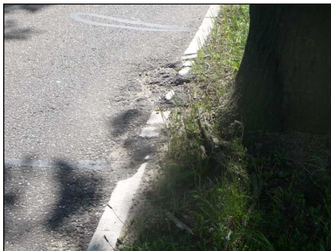
Voorbeeld randschade asfaltverharding
