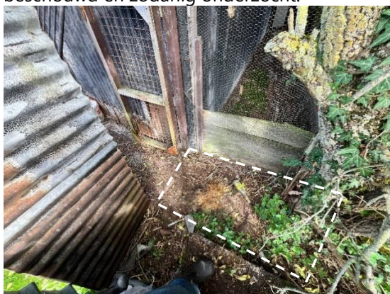
foto: infiltratiepunt zuidelijke gevel
