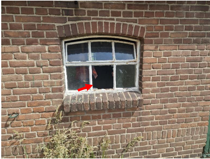
Figuur 10 De schuur van Nijkerkerweg 128 is via een kapot raam (zie rode pijl) toegankelijk voor steenuil en kerkuil; dit gebouw wordt mogelijk gebruikt als nest- en rustplaats
