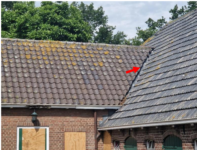
Figuur 18 Openingen bij de kilgoot van het dak van het woonhuis van Nijkerkerweg 128 waar vermoedelijk nestplaatsen van huismus op het dakbeschot aanwezig zijn
