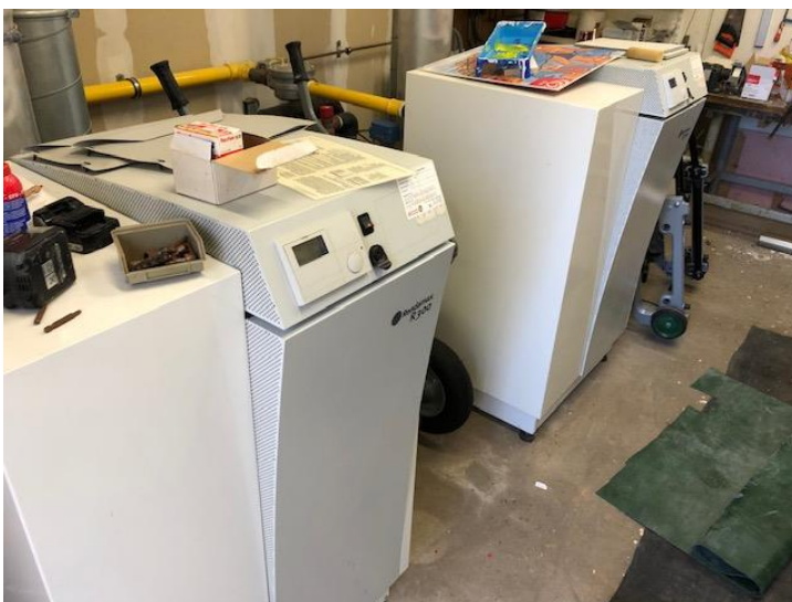
Afbeelding 2, Warmteopwekking en warmwaterbereiding Goffertbad
