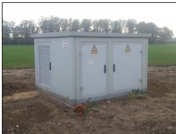
Figuur 25: voorbeeld trafo-station
