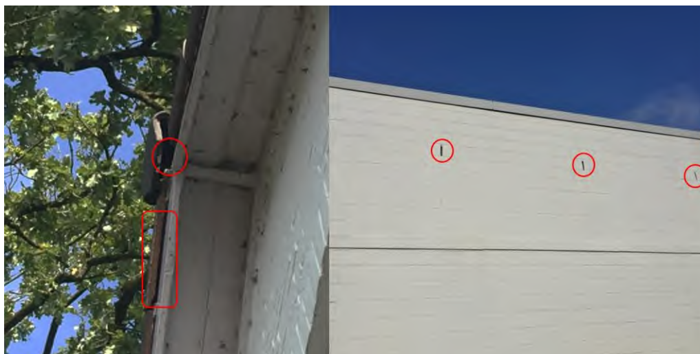
Figuur 4 Links de uitstekende gevel met kierende kant- en nokpannen en rechts openstootvoegen kunnen geschikt zijn als in- en uitvliegopening en leiden naar een rust- en verblijfplaats.
