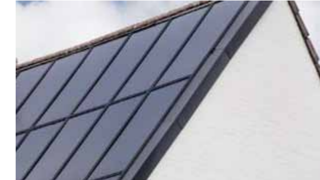
PV geïntegreerd in het dak
