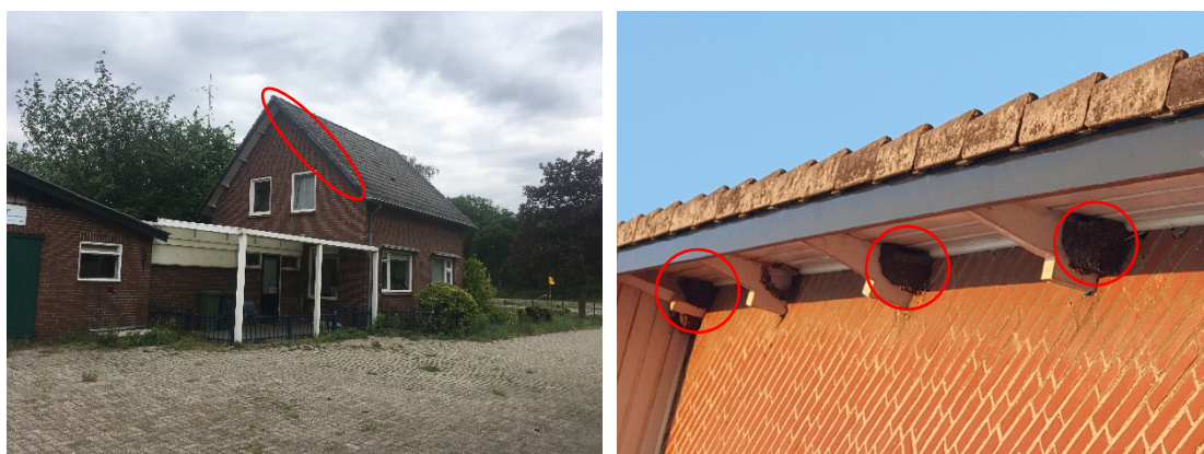
Figuur 3.8 Aangetroffen bezette nesten van de huiszwaluw in gebouw 1 (rode cirkel).
