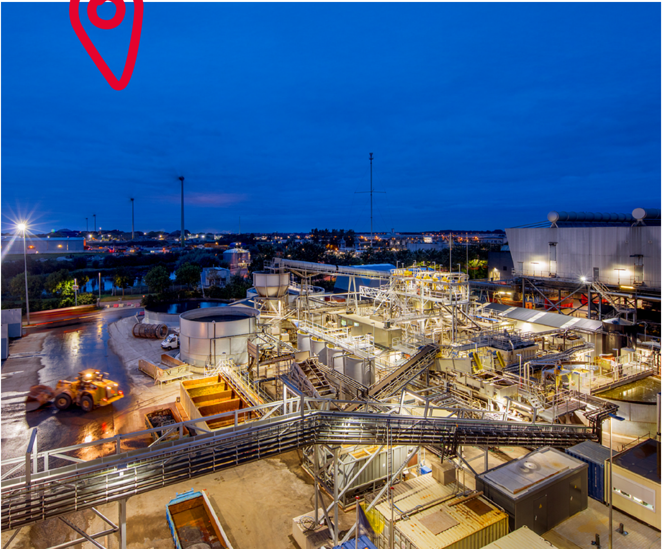
De bodemas-wasinstallatie maakt het mogelijk om bodemas te hergebruiken. Dit doet HVC samen met Boskalis Environmental.
