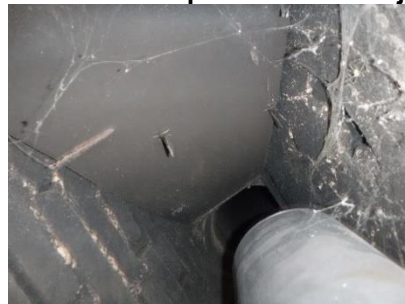
Foto 54 verdachte buis schoorsteen opstal 7
