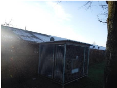
Foto 47 asbestvrije golfplaten op hondenhok
