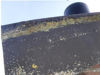
Foto 39 NT-kenmerk op asbestvrije golfplaten
