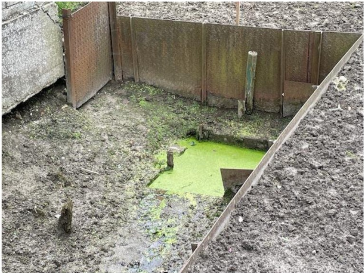
Dit is nu de waterafvoer bij nr [REDACTED] Betonnen buis rond 300
