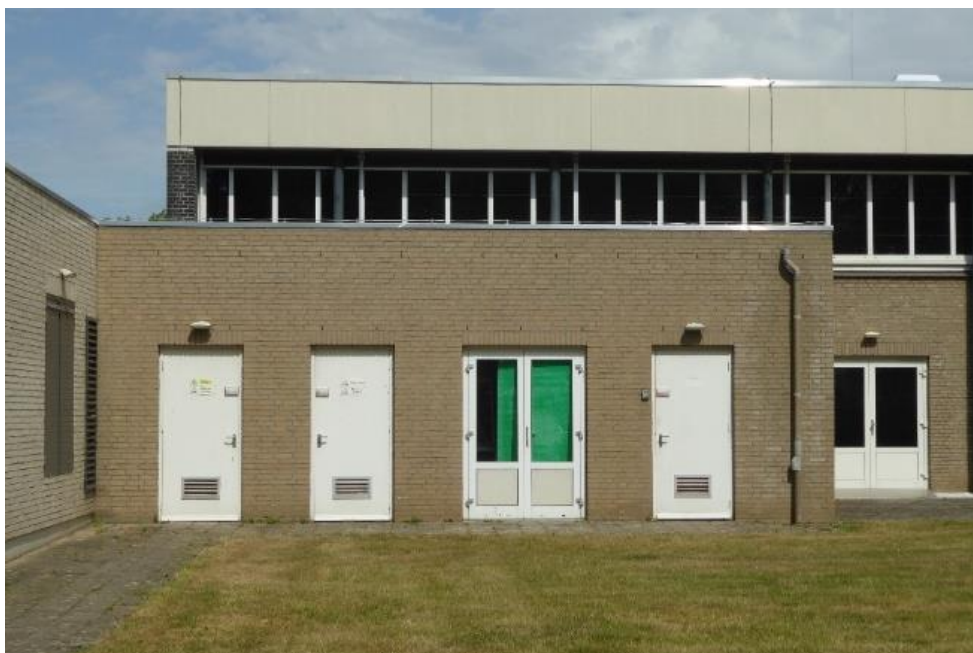
Afbeelding 25. Aangetroffen open stootvoegen aan de zuidgevel en 10 vleermuiskasten aan de oostgevel.
