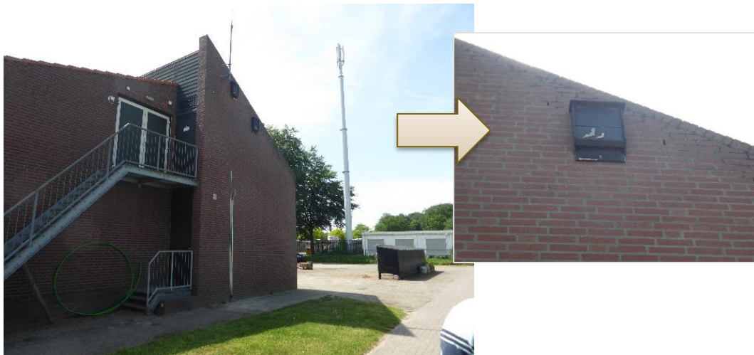
Afbeelding 23. Aangetroffen vleermuiskasten en open stootvoegen aan de noordgevel van de oude hoeve binnen deelgebied 2.
