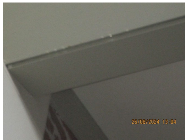
afb. 3.2: locatie lekkage aan de binnenzijde.
