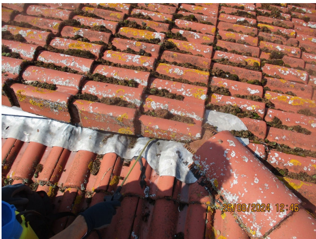
afb. 3.3: locatie waterproef water gaat via verzakt lood; onder de hoekkeperband de constructie binnen.
