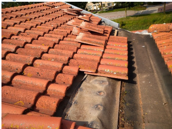
afb. 2.19: strook DPC folie over laatste panlat, lekwater kan achter EPDM dakbedekking terecht komen.
