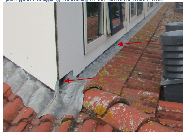
afb. 2.18: aansluitingen lood staan open/uitgezakt, golf pan geeft toegang neerslag in combinatie met wind.
