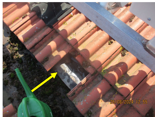
afb. 2.28: water kan achter de folie komen en onder de folie doortrekken, versterkt door de alg en mosgroei en relatief ver doorlopend dakvlak.
