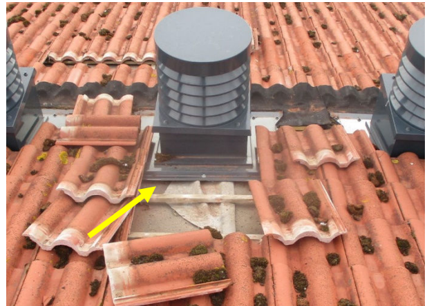
afb. 2.26: dakfolie geplooid en niet afwaterend op de goot van de dakdoorvoer, eventueel lekwater kan via de doorvoer naar binnen.
