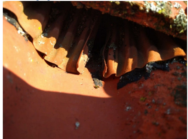
afb. 2.24: openstaande naad in ondervorst.
