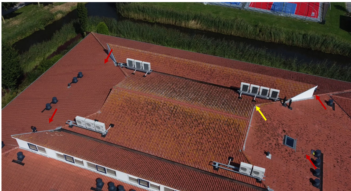
afb. 1.4: overzicht hoofd dak met locaties gericht onderzoek en geel de plek waar de lekttest is gedaan
