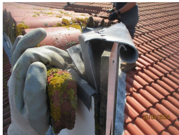
afb. 2.14: aansluitingen dakrand staan open.
