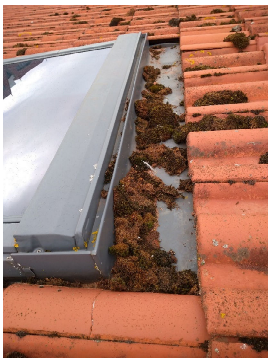
afb. 2.9: mosophoping in de goot verhindert het afstromen van water, breuk in pan.
