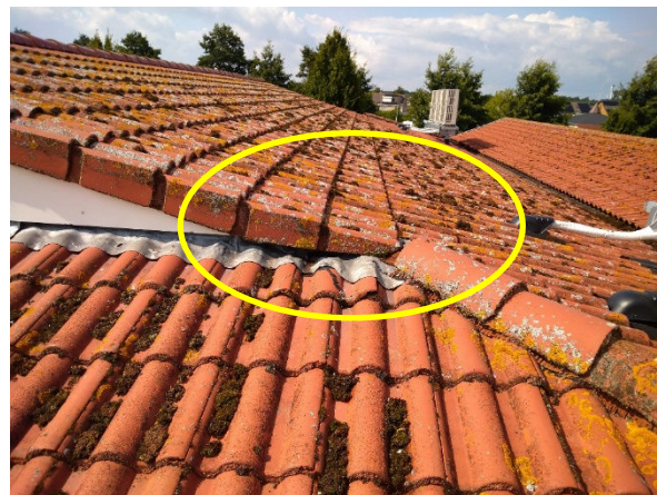
afb. 2.20: aansluiting lood tresp gevelpannen en vorst, hier is toegang voor wind en water. Dit is met een watertest aangetoond.
