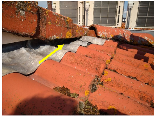
afb. 2.22: aansluiting lood trespas gevelpannen en vorst, hier is toegang voor wind en water.
