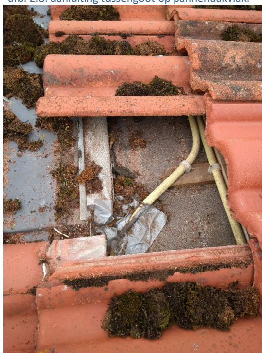
afb. 2.10: electrabuizen over/door dakfolie. Dakfolie overlapt de goot niet.
