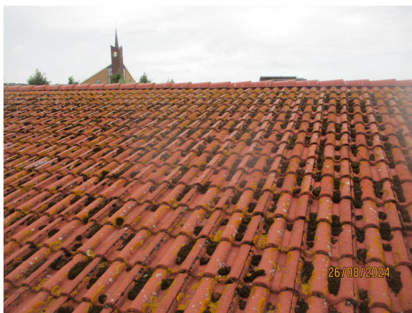
afb. 2.27: algemeen geldt dat er veel mos op het dak licht. Dit vertraagt de droging en bevordert infiltratie van water.
