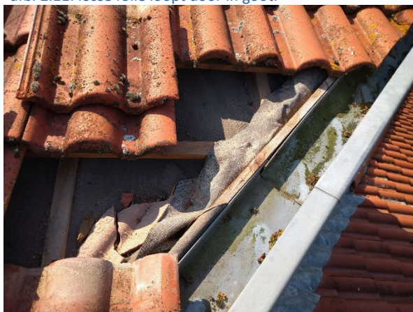
afb. 2.13: folie rommelig en watert niet af in goot, situatie niet meer volgens tekening, lasnaden zinken goot plaatselijk in matige staat.
