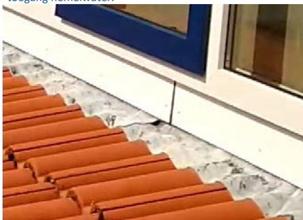
afb. 2.17: lood aansluiting staat open mogelijke toegang hemelwater, tresp ongeventileerd. Tropa te laag; niet volgens detail.
