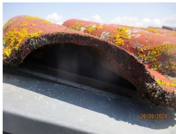
afb. 2.16: aansluitingen dakrand staan open, gegolfde pan geeft toegang neerslag in combinatie met wind.
