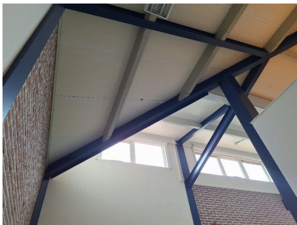
afb. 2.7: waterschade komt tot uiting tussen randen dakelementen.
