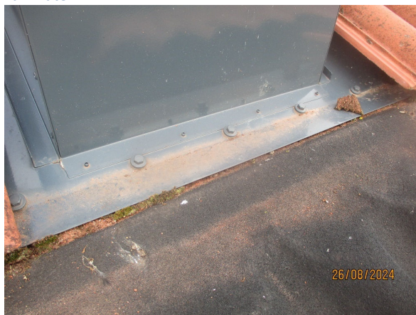
afb. 2.29: aanwezige dakdoorvoeren en voorzieningen liggen onder het vlak van het dak waardoor water zich kan verzamelen.
