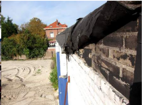
b) zijgevel (zuid-west) met bitumen
