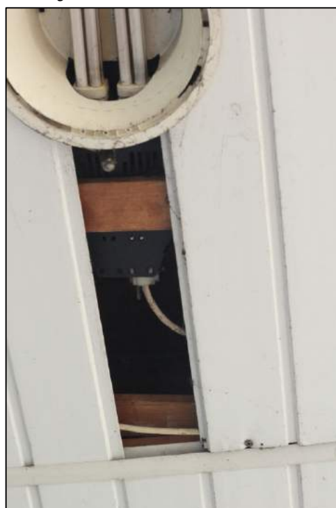
Foto 6: toegang tot binnenkant gebouw door achterstallig onderhoud
