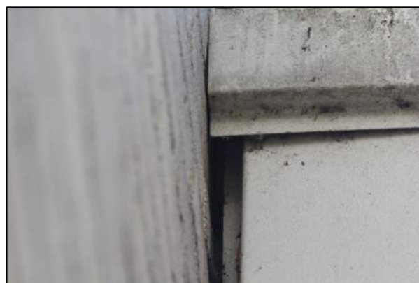
Foto 4: kieren/spleten aansluiting te slopen gebouw Schönberglaan 8
