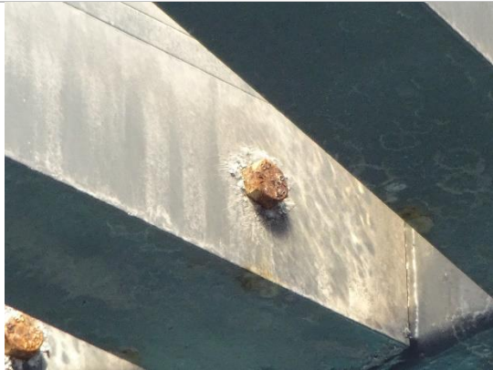
Bouten aluminium koepelconstructie vertonen corrosie en zijn RVS
