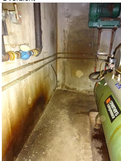
Schades kelder constructie, corrosie aantasting, kalkuitbloeiing
