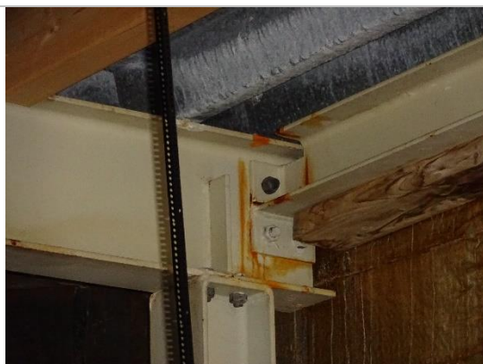
Locatie 4 – Lichte corrosie verbinding ligger, kolom, gording
