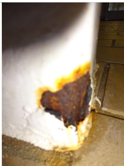
Locatie 1 - Schade kolomvoet
