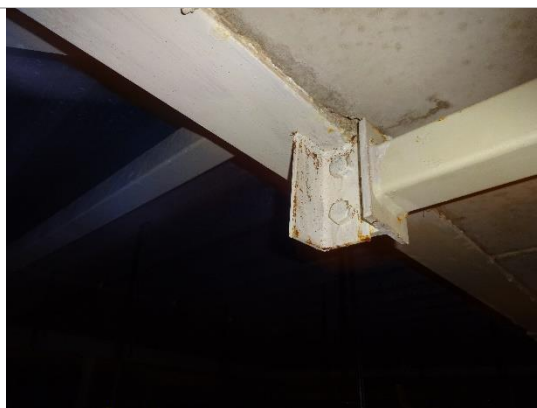
Locatie 3 – Lichte corrosie op constructie elementen
