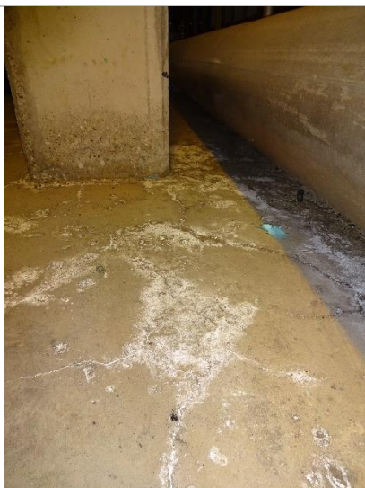
Scheurvorming en kalkuitbloeiing vloer
