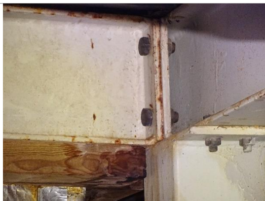
Locatie 1 – Lichte corrosie op constructie onderdelen
