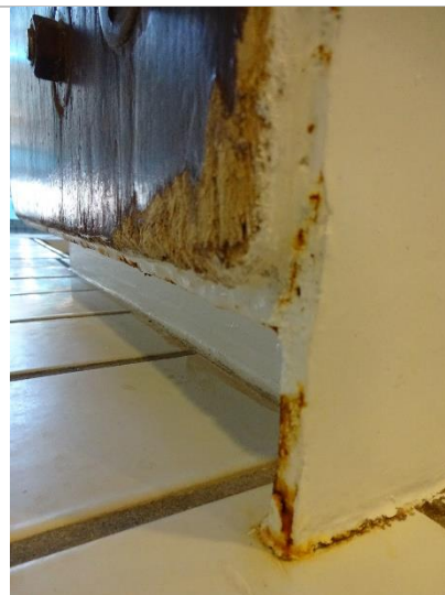
Kolomvoet spant – lichte corrosie en lichte beschadigingen houten spant
