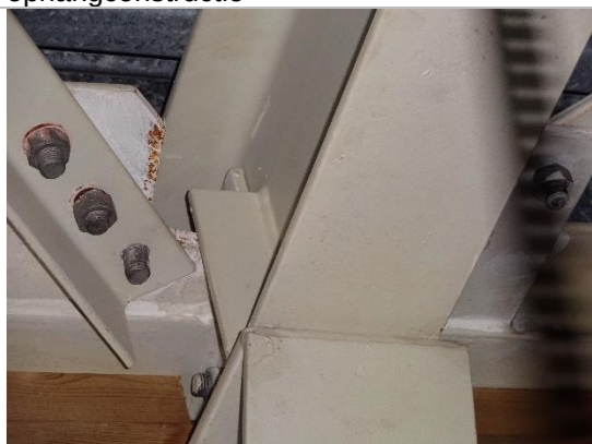
Locatie 3 – Lichte corrosie aantastingen verbind ligger kolom windverband
