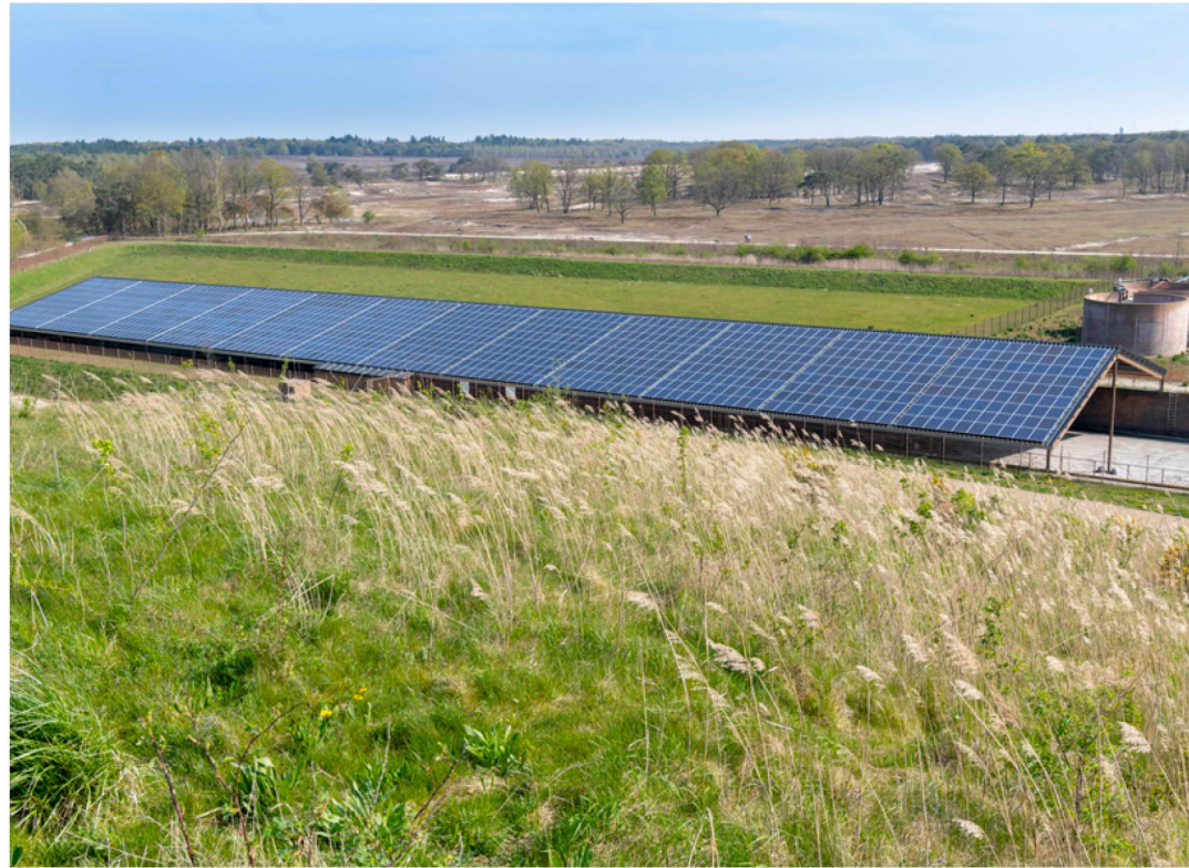
Zonnedak boven bufferbak rioolwaterzuivering bij Anna's Hoeve, collectief zonnedak met 2160 panelen via Hilverzon met ongeveer 200 gezinnen die erin participeren. Foto: Margot Brakel
