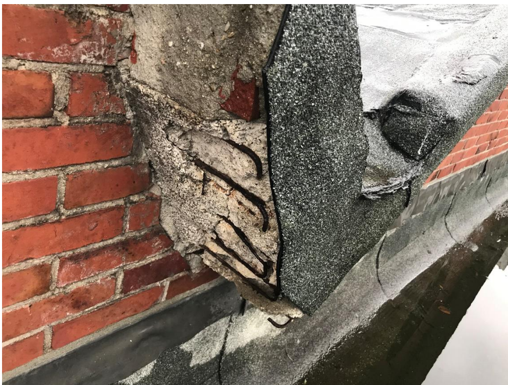
afb. 6 De onderzijde van de betonafdekkingen zwaar aangetast
