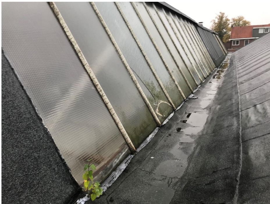
afb. 4 Kapotte beglazing en weggezakte loodslabben
