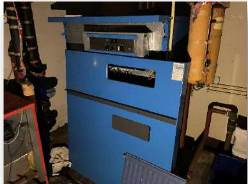
Overzicht ketels in cv-ruimte
