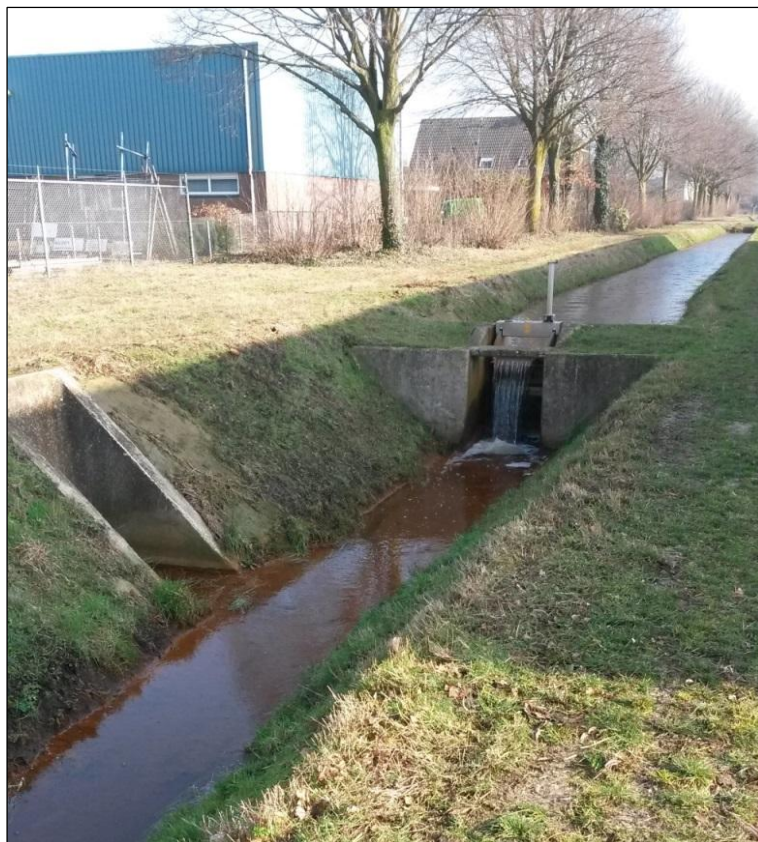
Afbeelding 5: Uitstroom riooloverstort Vlonder Noord en stuw
