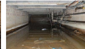
Grondwater in kruipruimte
