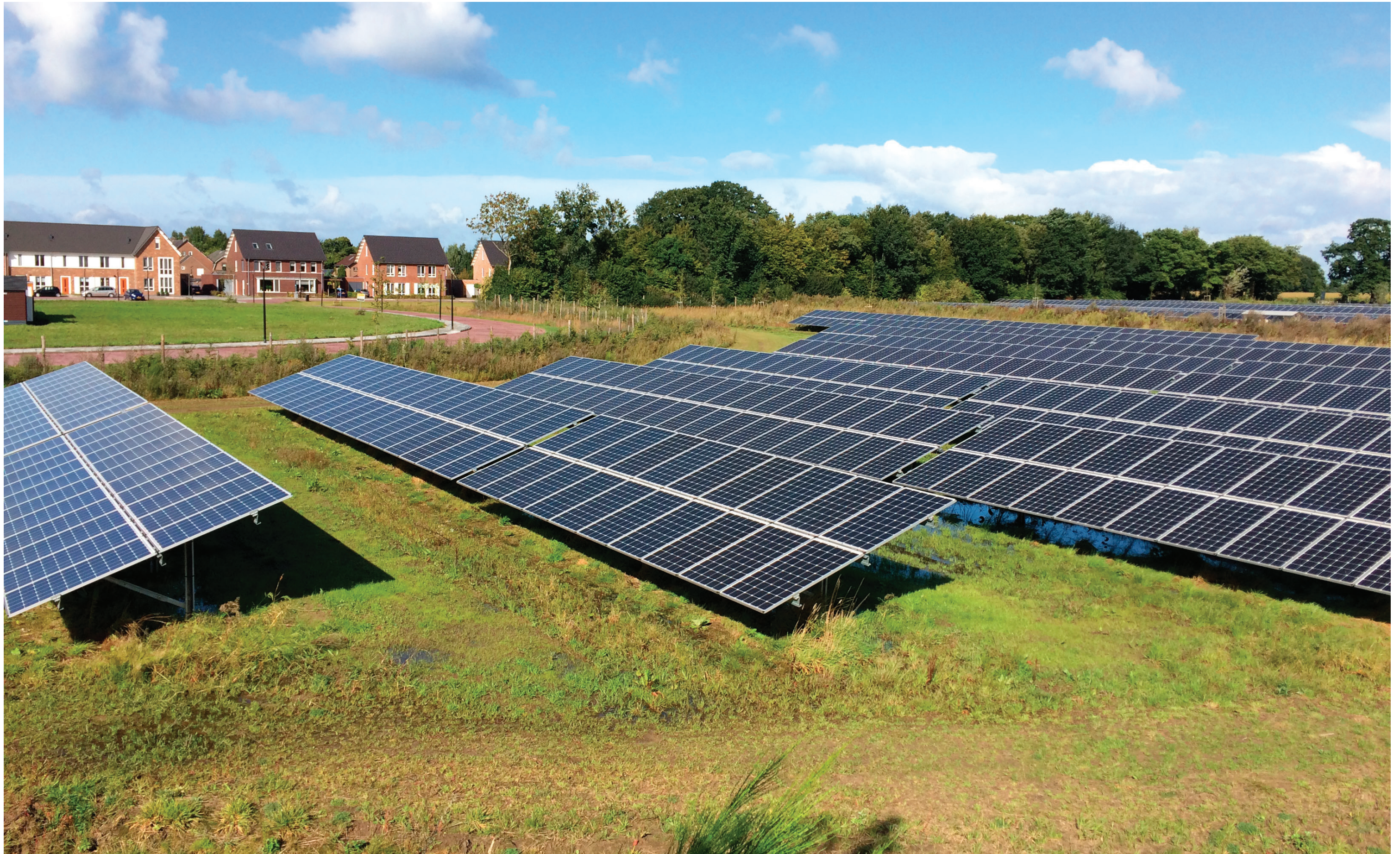
Voorbeeld openbaar zonnepark De Kwekerij in Hengelo (GLD)
