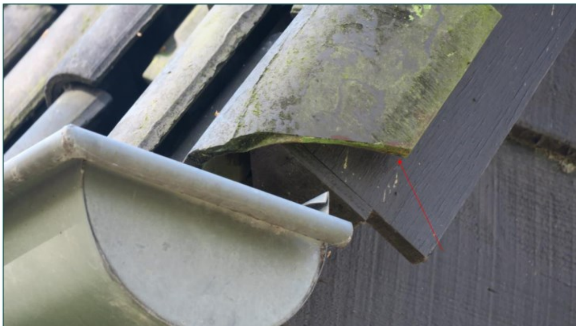
Figuur 3.4 In de woning zijn er kierende kantpannen aanwezig die gebouwbewonende vleermuizen toegang geven naar de ruimte tussen de dakpannen en dakbescot.
