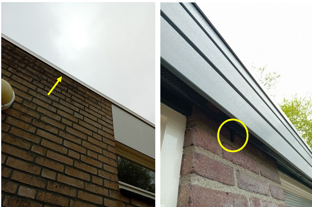
Figuur 1. Voorbeeld van invliegopening onder de daktrim (gele pijl) en open stootvoeg (gele cirkel).
