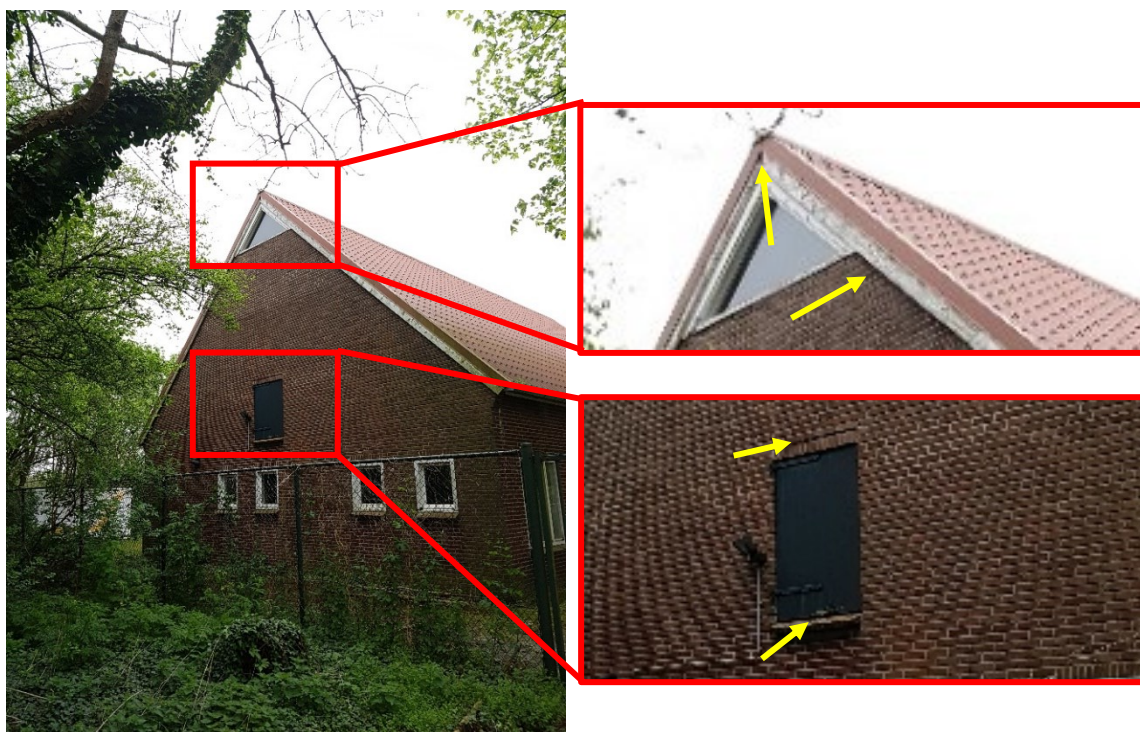
Figuur 7. De zuidwestelijke gevel van het gebouw op het kampeerterrein met verschillende invliegopeningen (gele pijlen).
