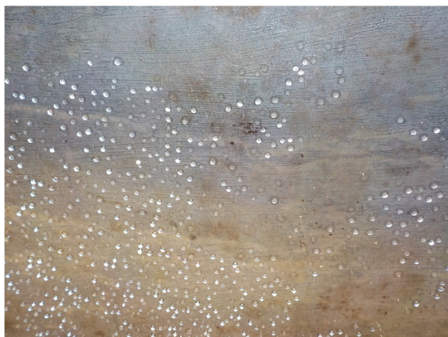
Foto 10 (condensvorming aan plafond)
