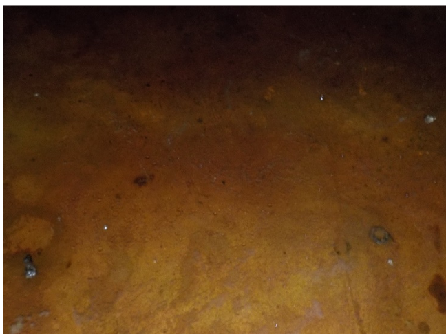
Foto 9 (detail laagje water vloer)
