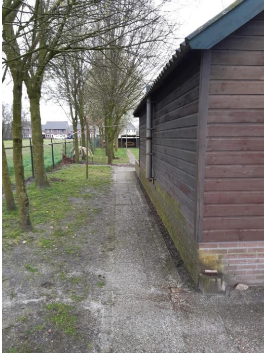
Omschrijving: Asbestverdachte dakbedekking zonder regenwaterafvoer
