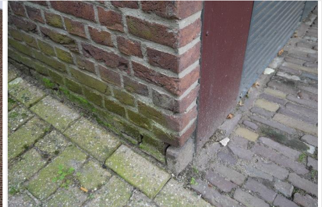
Metselwerk hoek zit losk
