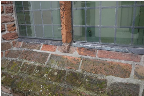
Loodwerk plaatselijk verdwenen
