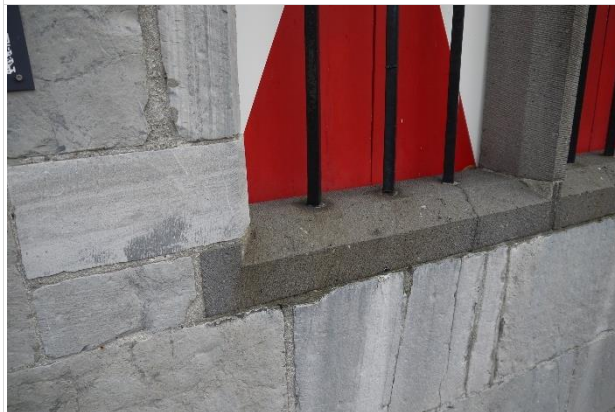
Staalwerk veroorzaakt spanning in het natuursteen
