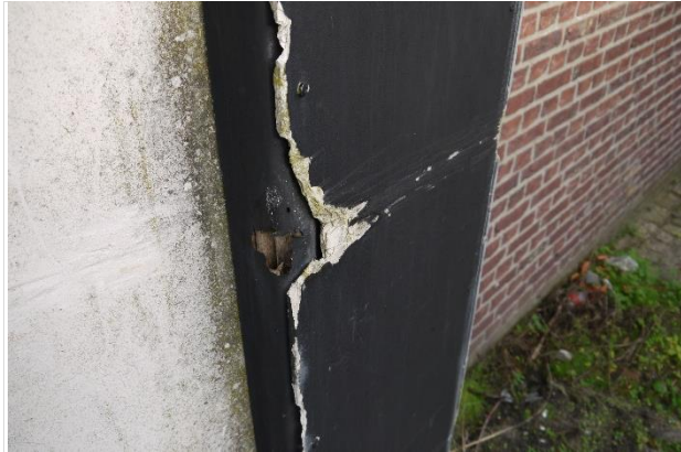
Trespa bekleding is beschadigd
