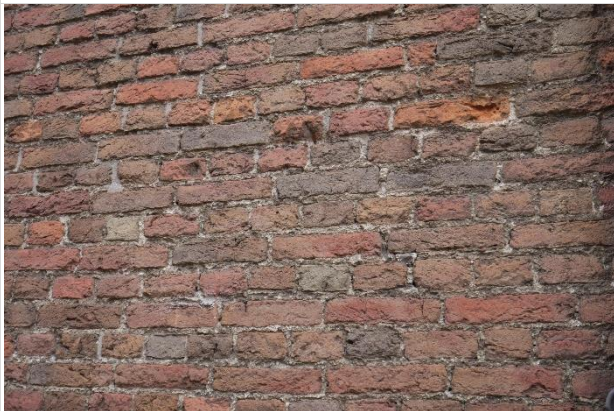
Metselwerk plaatselijk verweerd
