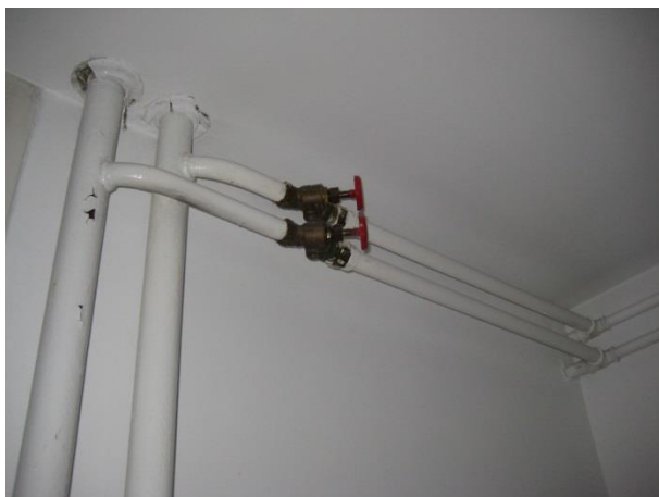
Foto 2-4: Stijg-/zakleiding per woning.
