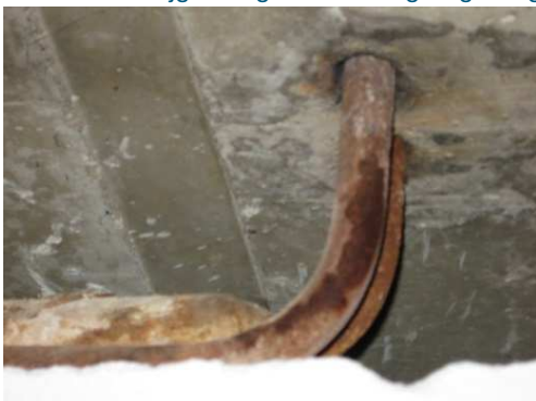
Foto 2-11: Stijgleiding verwarming begane grond.
