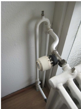
Foto 2-13: Doorverbonden leiding bovenste bouwlaag.
