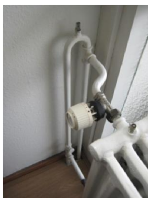
Foto 2-6: Doorverbonden leiding bovenste bouwlaag.
