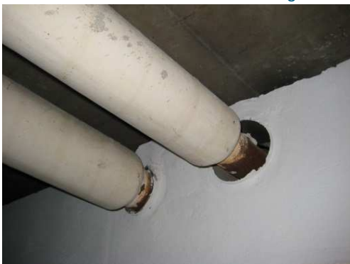
Foto 2-10: Horizontale verdeelleiding verwarming.
