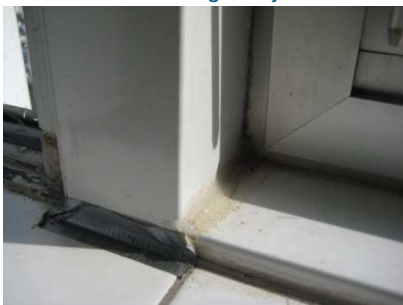
Foto 2-5: afdichting kozijn woonkamer.
