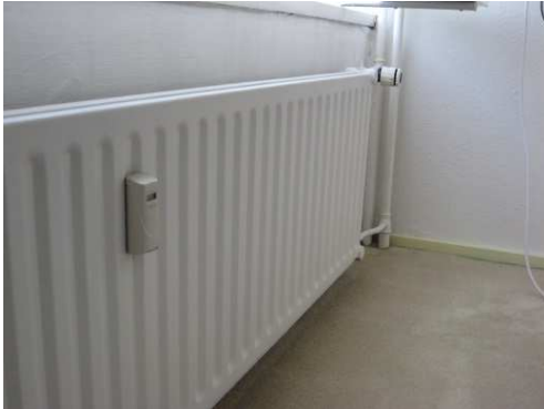
Foto 2-12: Stijgleiding met radiator en EKV.
