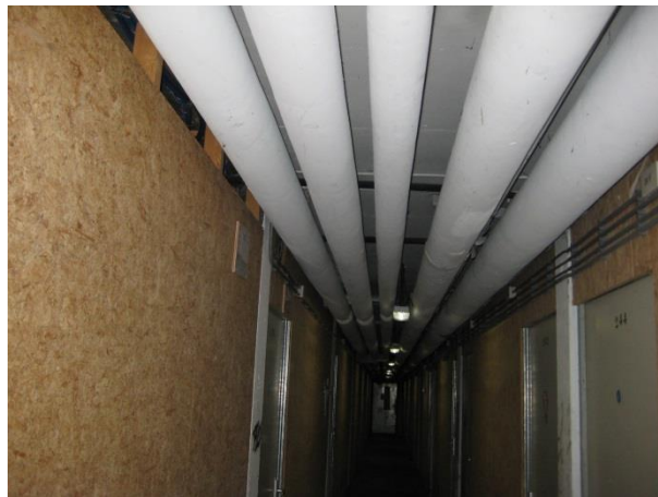
Foto 2-3: Leidingnet onderste bouwlaag (Rhodosdreef)
