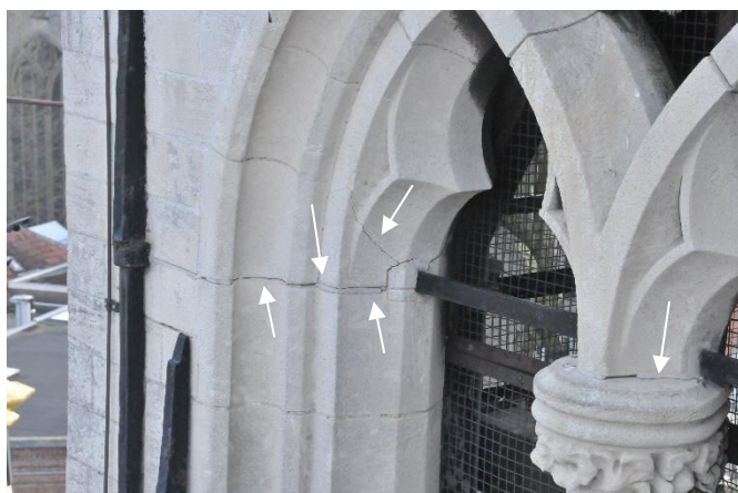
Afb. 6 - Brugstaaf veroorzaakt noemenswaardige scheurvorming als gevolg van uitzetting
