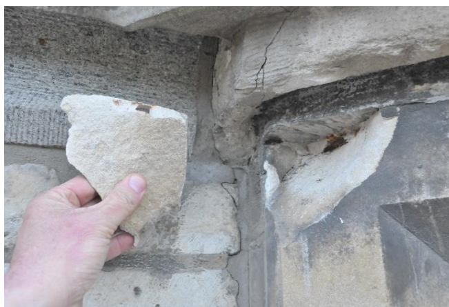
Afb. 7 - Loszittend deel aan de onderzijde van de linker hoektoren verwijderd tijdens onze inspectie, hierachter is roestend ijzer aangetroffen
