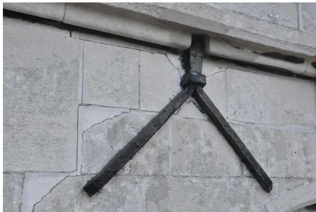
Afb. 4 - Scheurvorming rondom gevelanker en eerder hersteld natuursteen weer gescheurd
