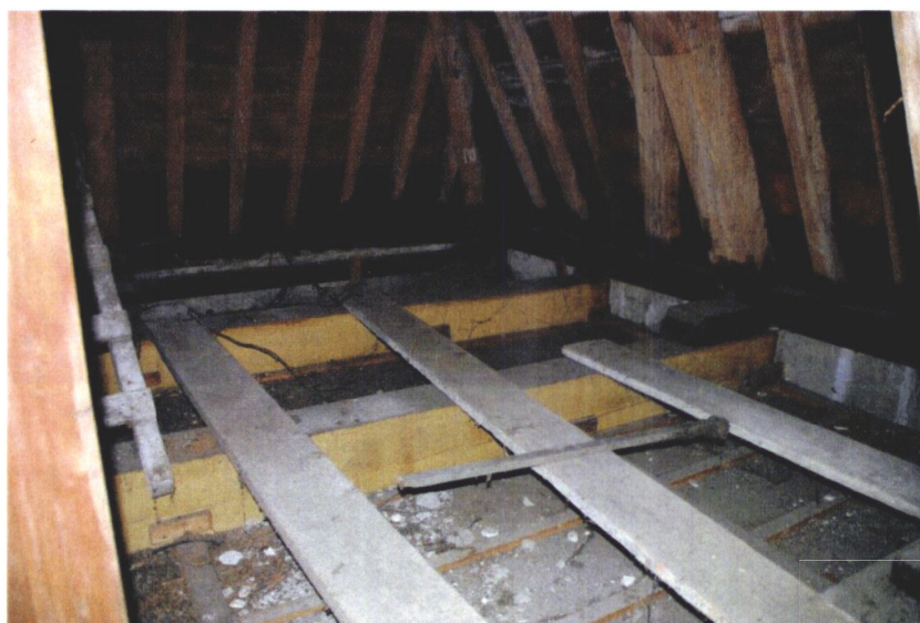
Op de vliering van de noordtoren is geen vloer aanwezig, zichtbaar tussen de balken is het board plafond
