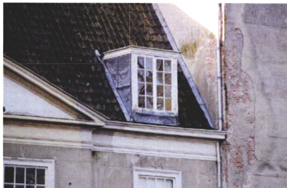
Middenvleugel op zuidtoren; loskomend pleisterwerk en oud zinkwerk
