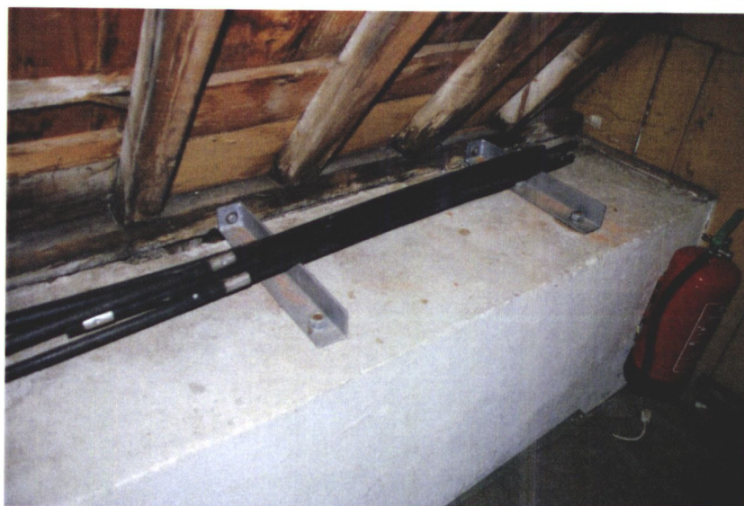
Weggeschoven muurplaat westvleugel met plaatselijke noodverankering
