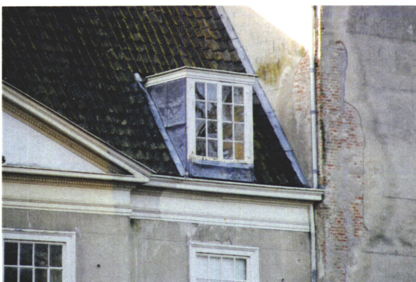
Aansluiting middenvleugel op noordtoren, o.a. wegvallend pleisterwerk
