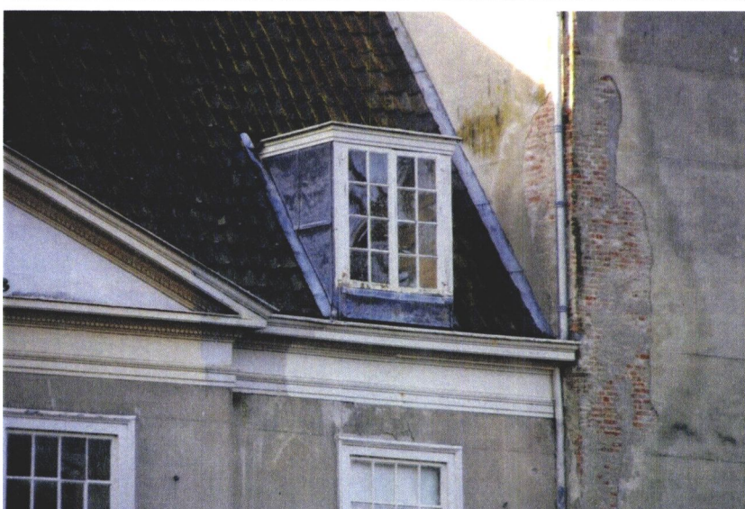
Aansluiting middenvleugel op noordtoren, o.a. wegvallend pleisterwerk
