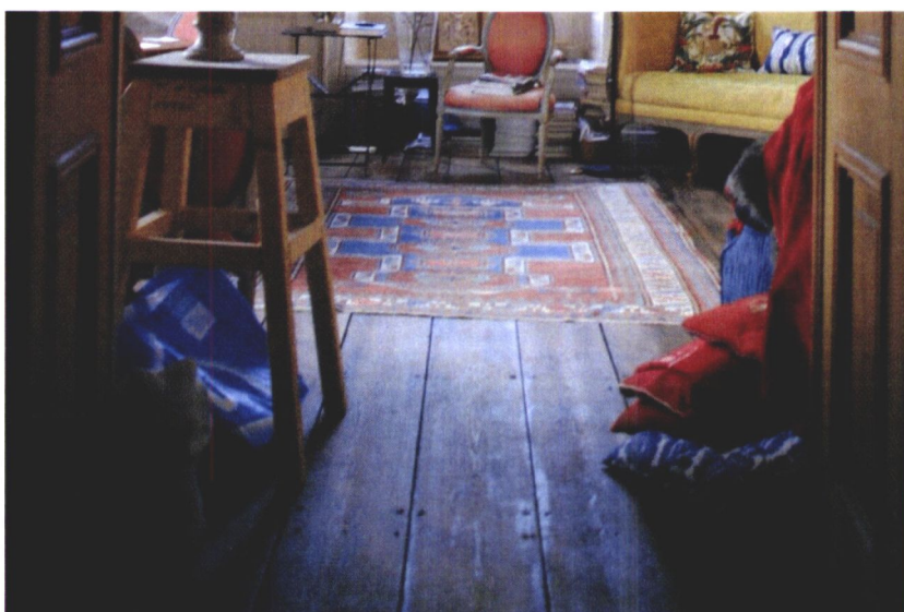
Houten vloer muziekkamer, hier is onder een onbekende ruimte, aangenomen gelijk aan westtoren en dus vermoedelijk ook hier rotte balkkoppen
