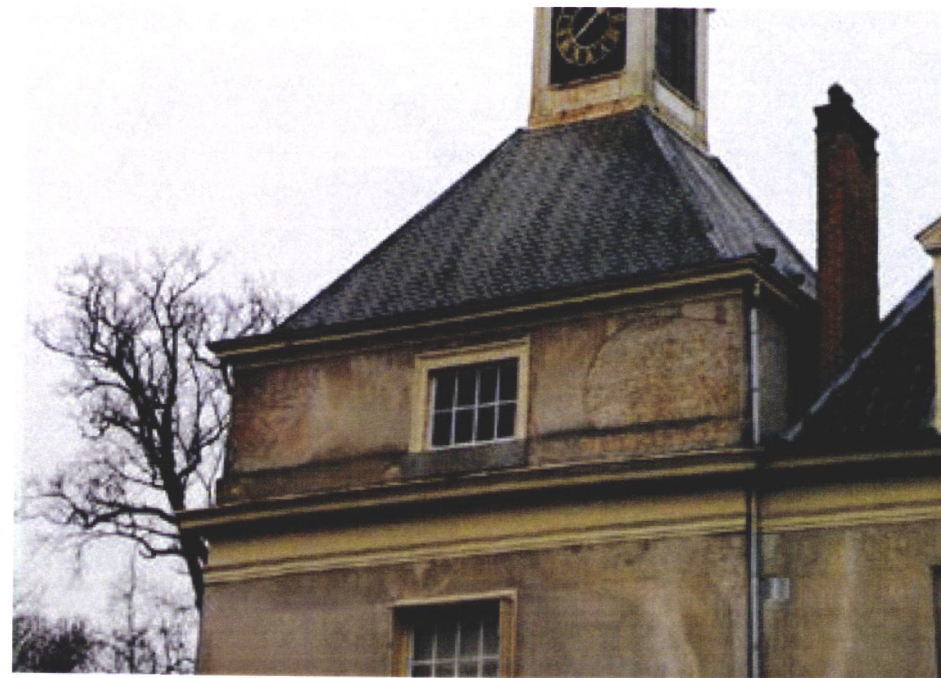
Zuidtoren; loskomend pleisterwerk en houtrot in de toren
