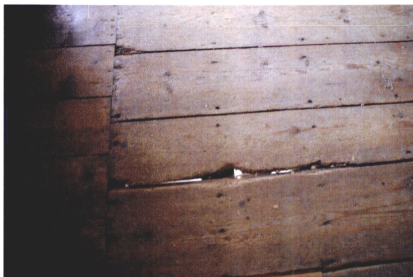
Aangetast vloerhout zolder noordtoren
