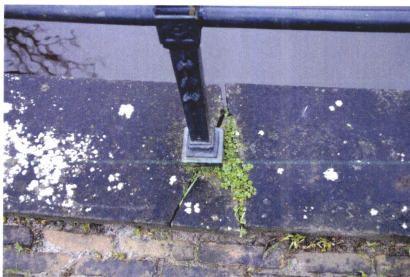
Schade inlaat brugleuning in hardsteen
