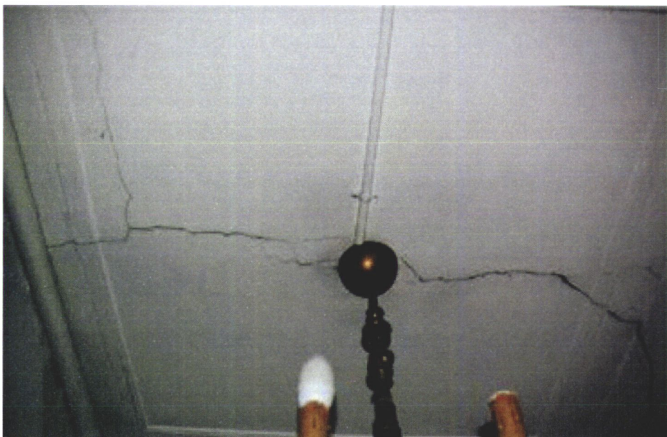
Scheuren stucplafond noordtoren door zettingsverschillend
