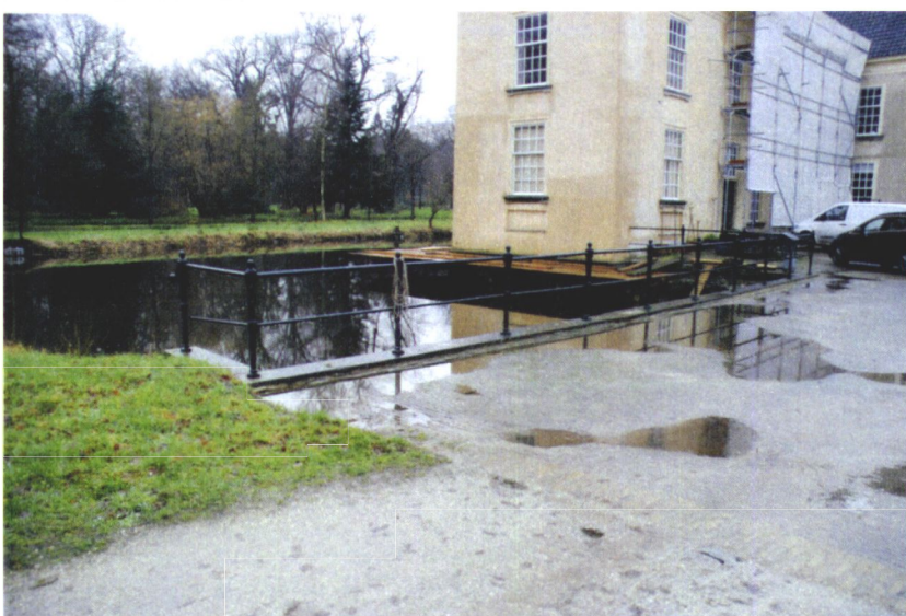
Niet afwaterende bestrating van de brug
