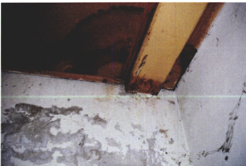
Aangetaste balkkoppen vliering noordtoren als gevolg van lekkages
