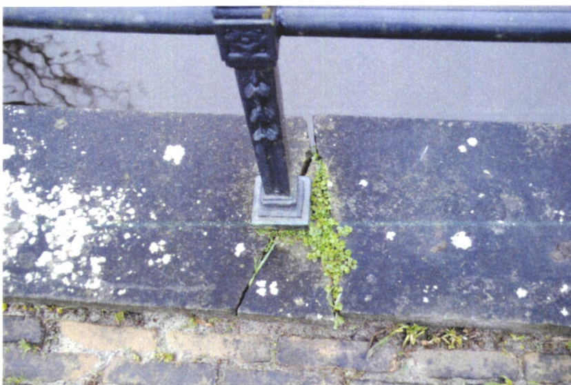
Schade inlaat brugleuning in hardsteen
