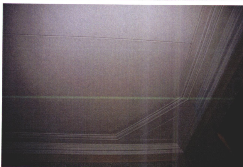
Salon eerste verdieping oosttoren, binnen stucwerk kader plafond afgetimmerd met zachtboard platen, vermoedelijk om schade van oude lekkages weg te werken
