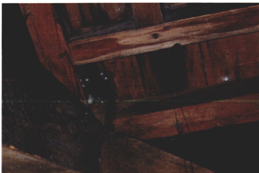
Aantasting houtwerk onder torenplat zuidtoren
