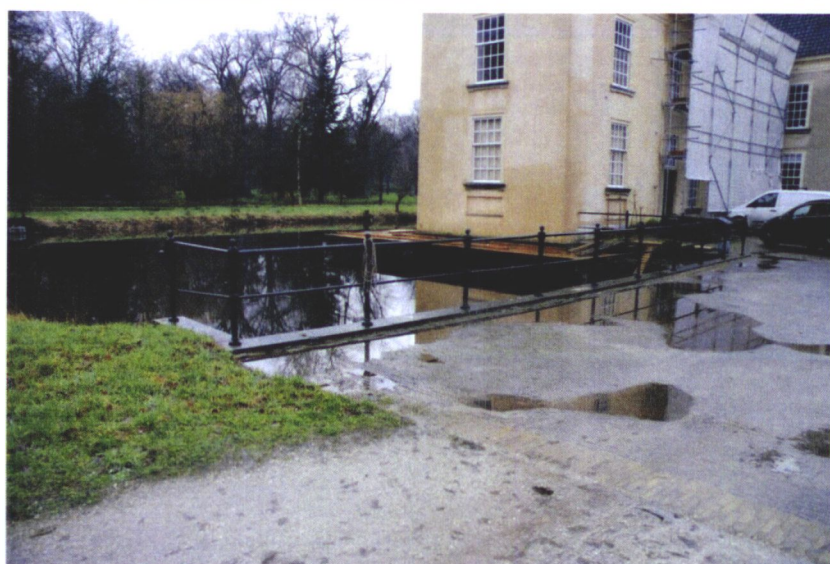
Niet afwaterende bestrating van de brug
