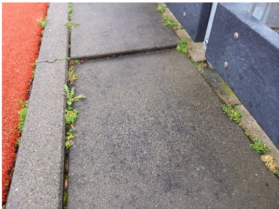
Verzakte tegel ter plaatse van lange zijde Oost
